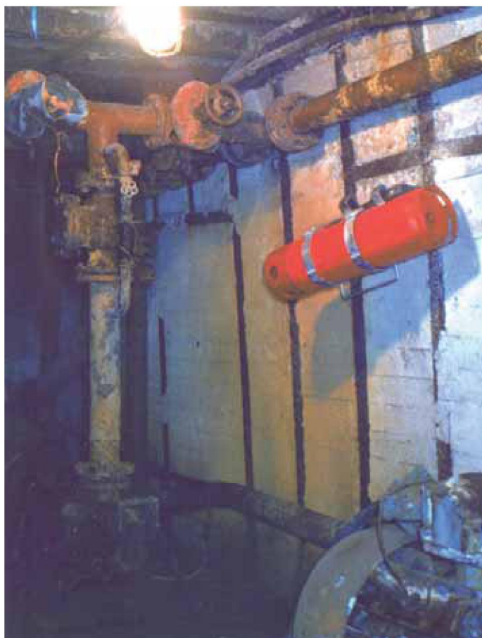
Рис. 2. Расположение огнетушителя в тупиковой горной выработке
